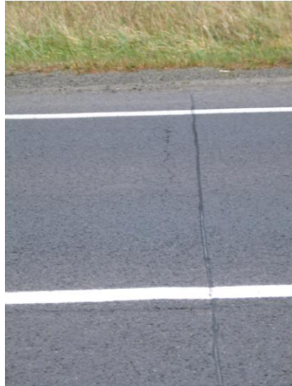
Rysunek 2.4 Typowy wygląd uszczelnionego spoiwem nacięcia w warstwie asfaltowej wykonanego nad dylatacją w leżącym niżej betonie. Obok widoczna powstająca niezgodnie szczelina.
