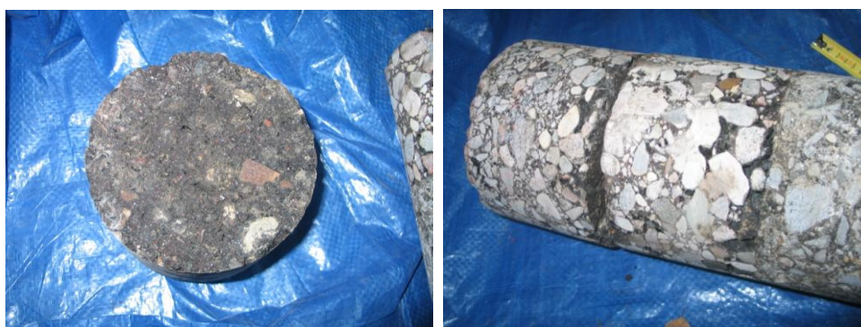
Rysunek 2.18 Po prawej: górna powierzchnia szczeliny odspojeniowej na granicy warstwy wiążącej i podbudowy asfaltowej, pozbawiona wyraźnych śladów pęknięcia poprzecznego. Po lewej: boczna powierzchnia rdzenia z widocznym odspojeniem między warstwą wiążącą, a podbudową asfaltową oraz wyraźną granicą dolną podbudowy asfaltowej. Na granicy widoczne są znaczne ubytki i wyszczerbienia wskazujące na zachodzący tam proces odspojeniowy.
